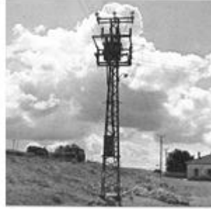
Resim 1.3: Köy trafosu (AC gerilimin alçaltılması)
